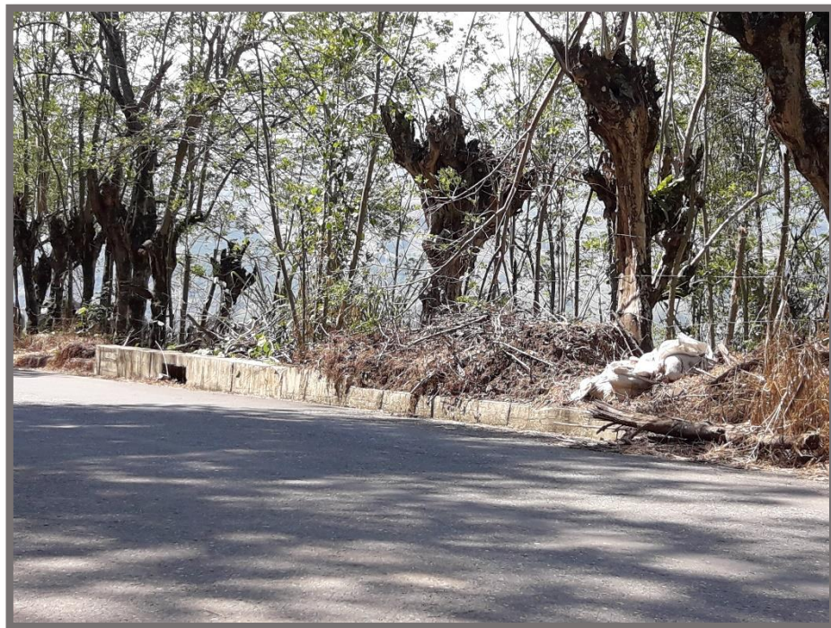
Figura 17. Tramo de la vía La Merced - La Felisa. Nótese que sobre la vía se encuentran algunas medidas para manejar el agua, pero estas no tienen el mantenimiento adecuado.
